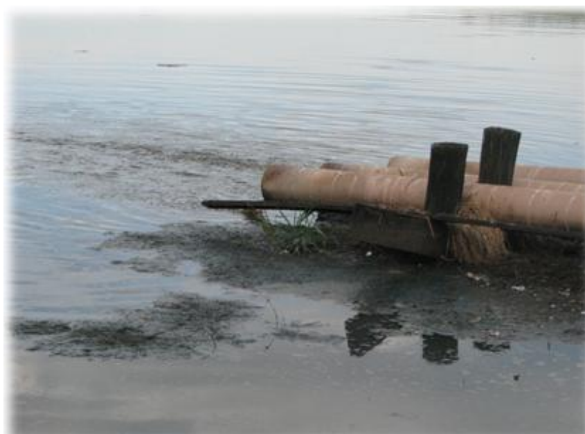
Imagem 10.3: Vista do dispositivo de entrada da lagoa anaeróbia.
